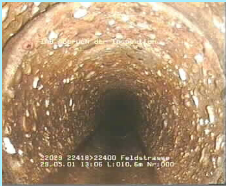
Korrosion (Zuschlagsstoffe sichtbar)
